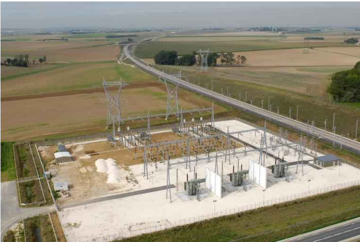
Figure 125: Exemple d'une sous-station électrique (Source : SNCF Réseau)
